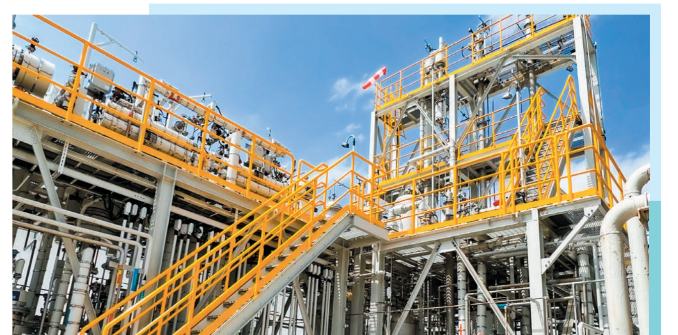
台塑煙道氣化學固碳試驗工廠
