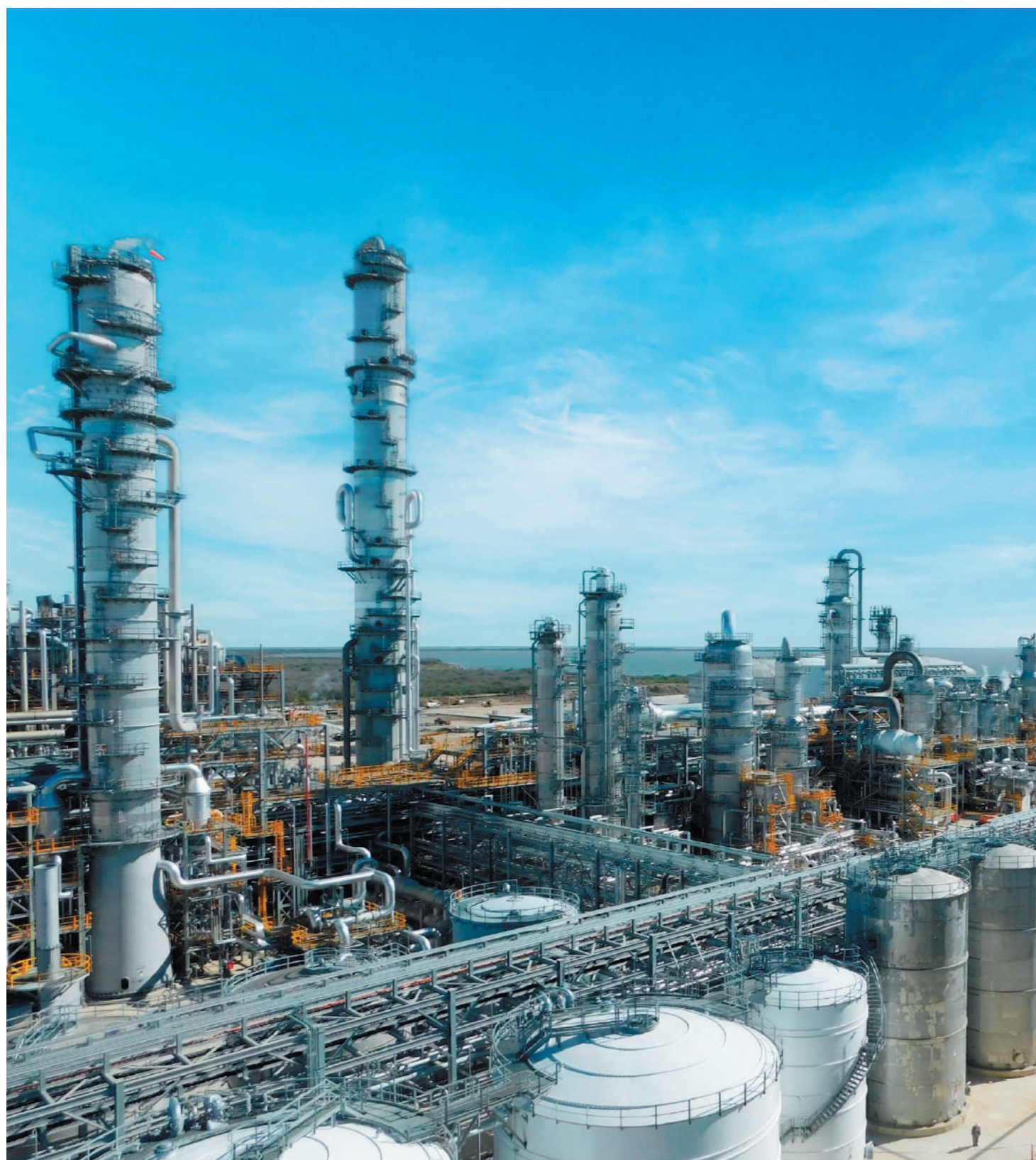
..... 美國德州廠區 EG-2 廠
